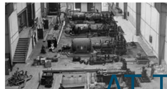
Teplárna Na Špitálce (foto: Teplárny Brno) Heating plant Na Špitálce (photo: Heating plants Brno)
